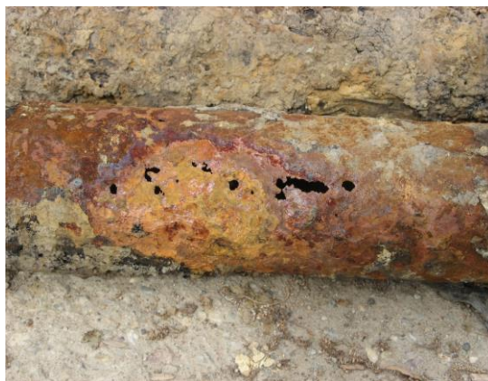
Fig.1.2. Defect de tip lipsă de material creat prin coroziune
