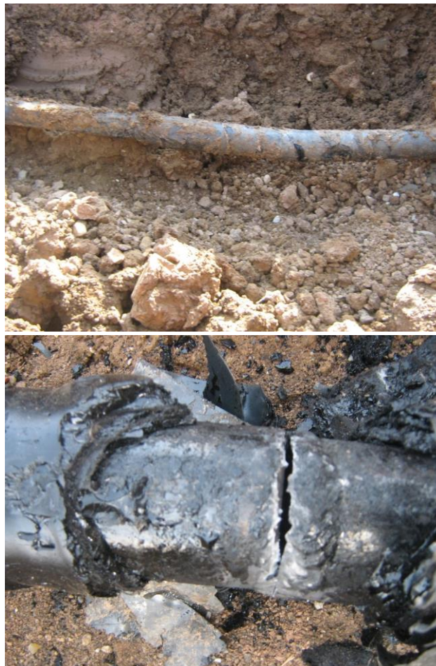
Fig.1.3. Defect de tip fisură cauzat de alunecare terenului
