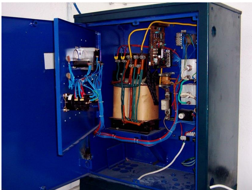
Fig.3.1. Stație de protecție catodică
