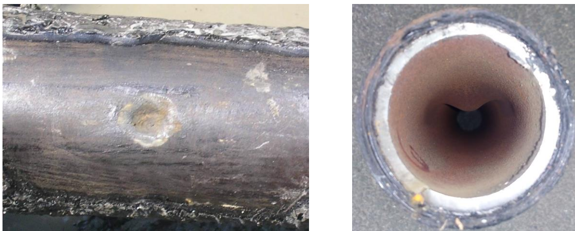
Fig.1.1. Defecte de tipul deformări locale, depistate pe tubulaturile conductelor
