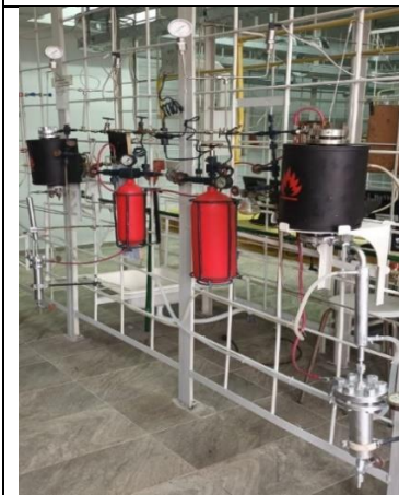
Figura 5. Instalație de hidrofinare a produselor petroliere
