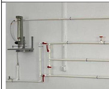
Figura 2. Instalație pentru studiul căderilor de presiune
